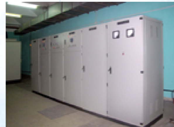
Tủ bảng điện tự dùng
